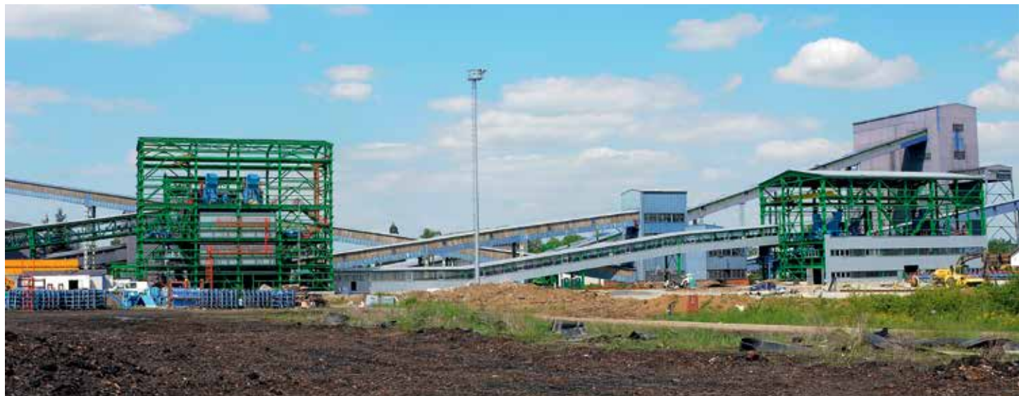
■ Део новог постројења за хомогенизацију угља
