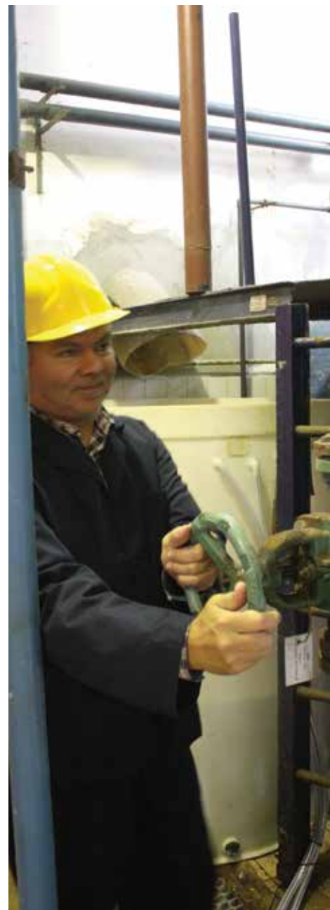
■ Постројење за омекшавање воде
