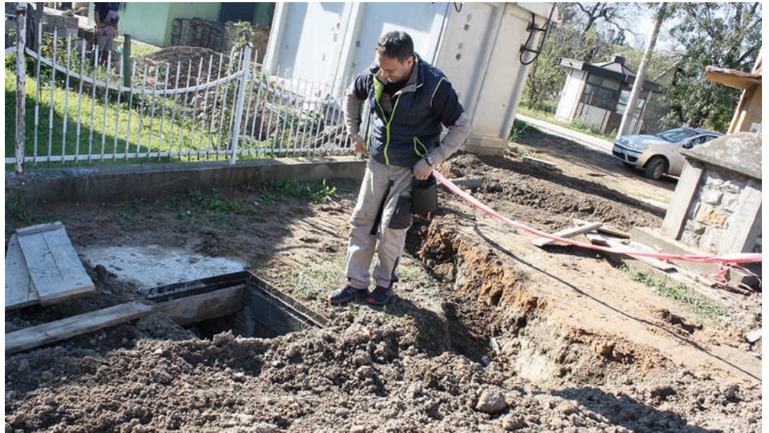
■ Нова подстанција у Музичкој колонији
