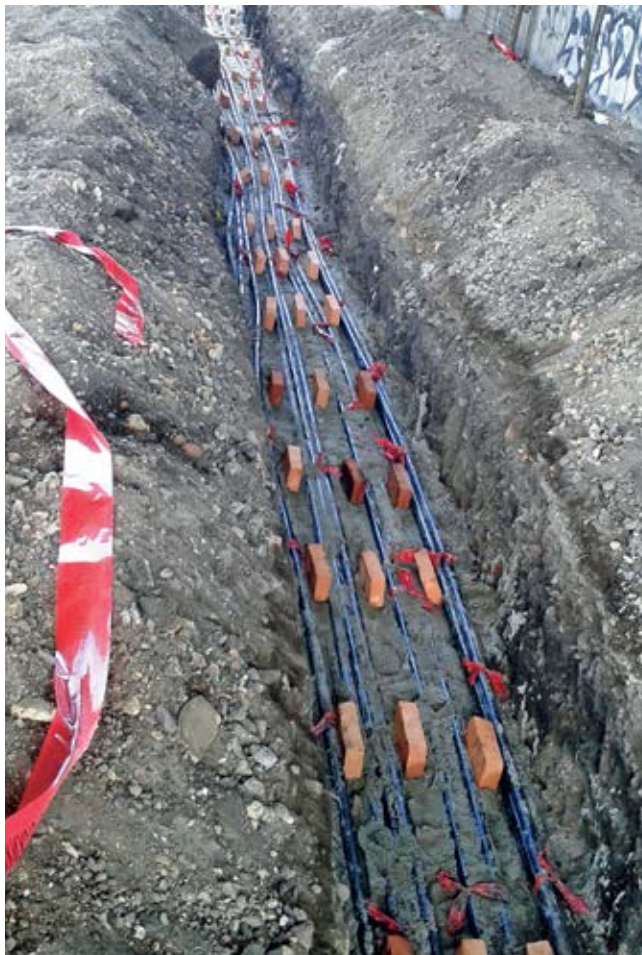
■ Нови 35 kV кабловски водови
