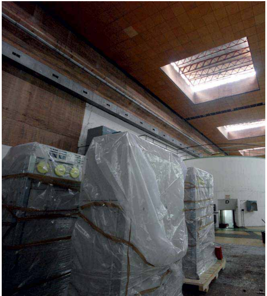
Део опреме већ стигао у електрану
