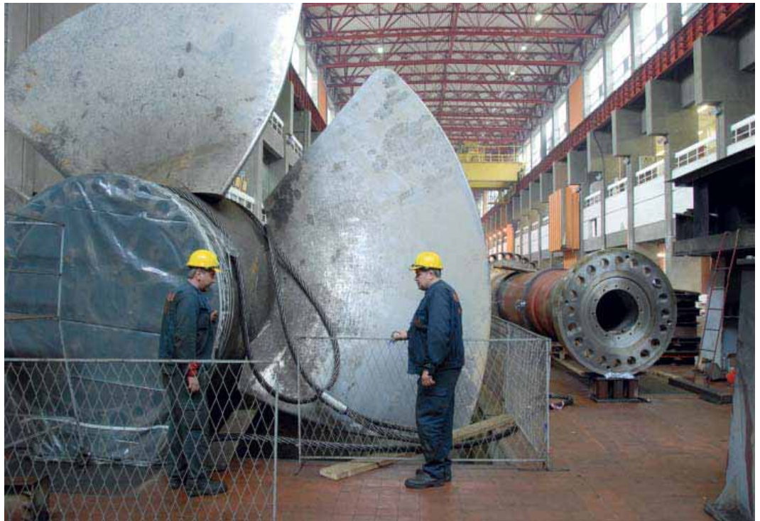
Вратило са радним колом турбине на монтажном блоку А-7
