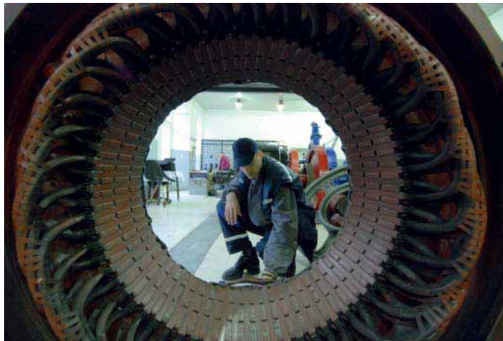
У ХЕ „Вучје“ могуће повећање инсталисане снаге
