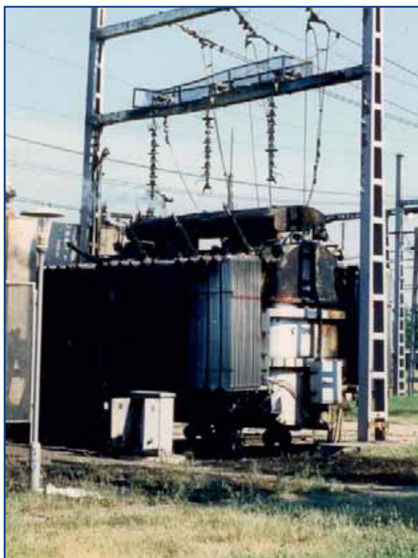
Трафо-станција „Београд 5“ у време бомбардовања
