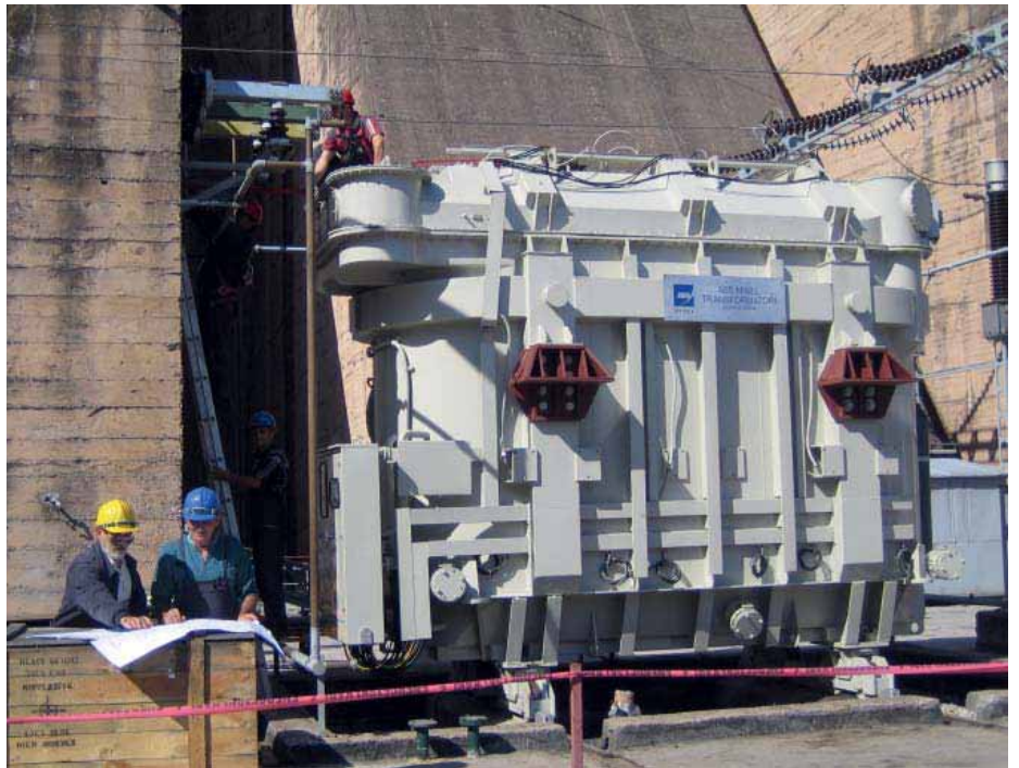
Нови блок-трансформатор са комплетном опремом тежак је 121 тону
