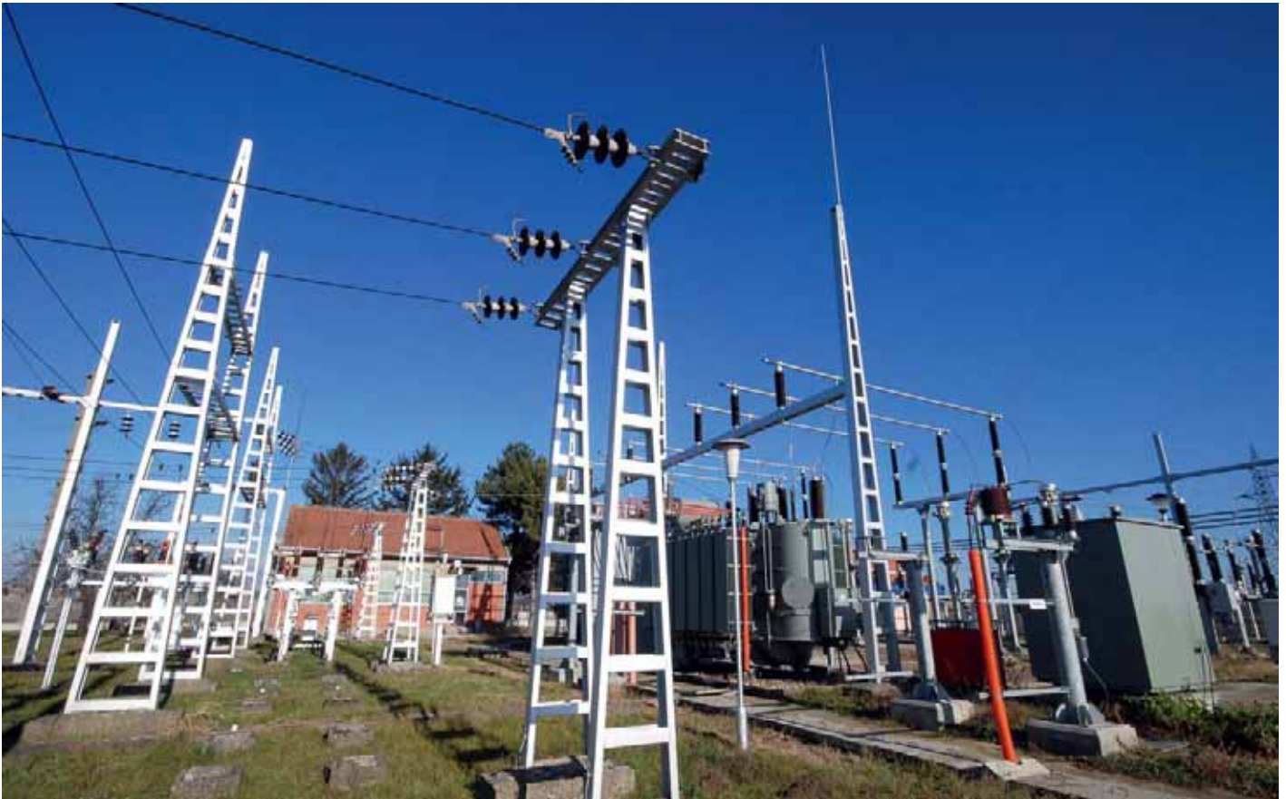
У «Електровојдини» највећи је број трансформација напона са 110 на 20 kV: ТС Рума
