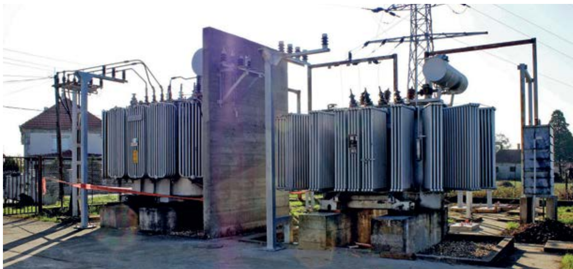
■ Трансформатори снаге два пута 8 MVA
