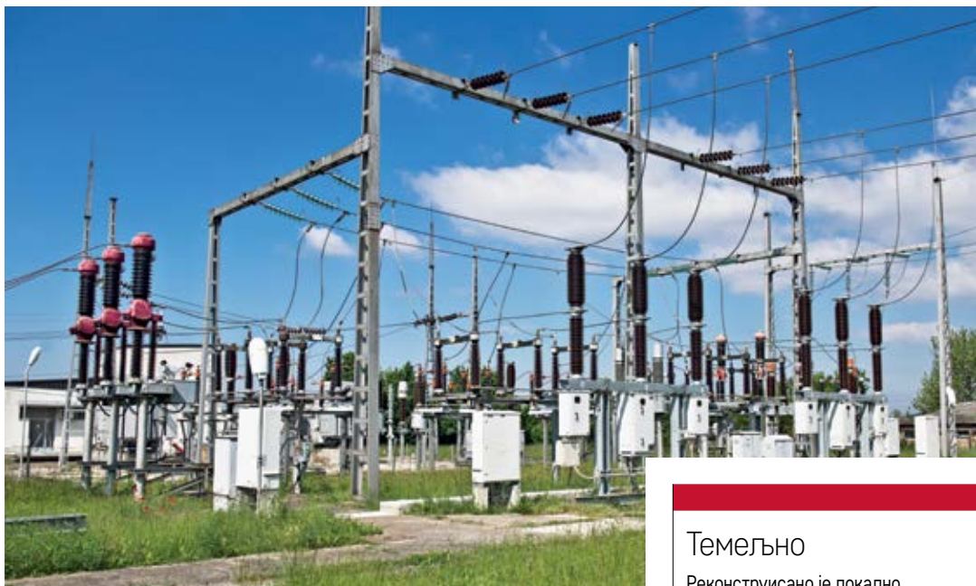
■ Модернизована трафостаница 110/20 kV „Инђија“
