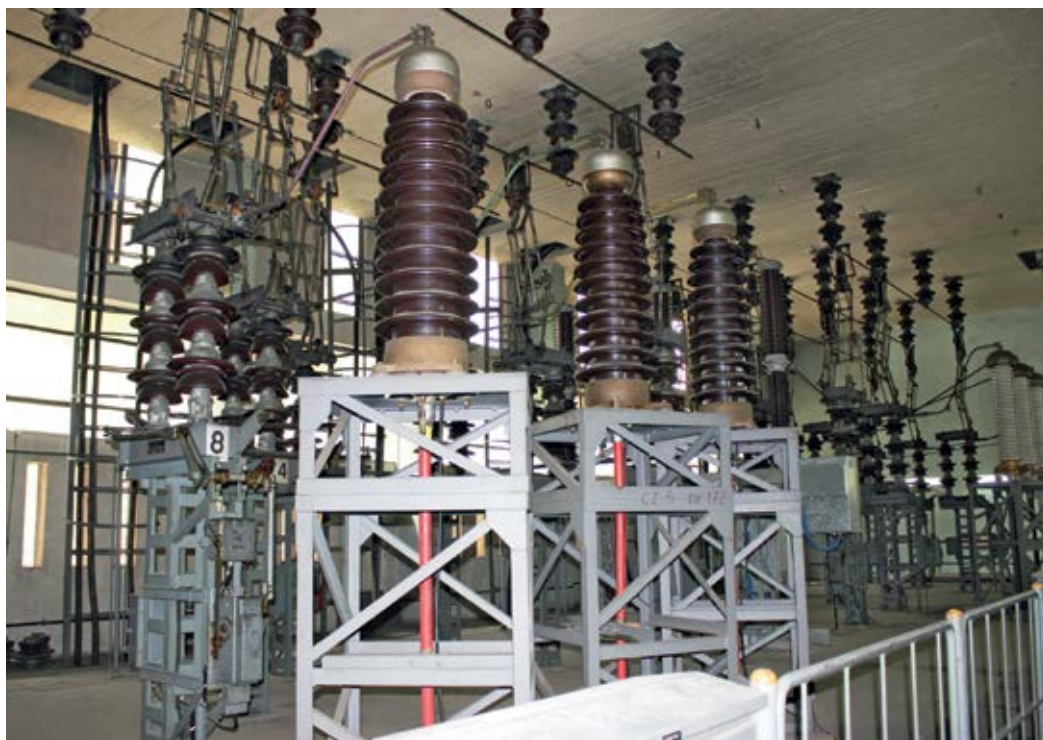
■ Трафостаница 10/35 kV „Београд 6“
