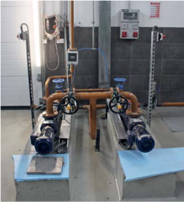
Унутрашњост постројења С2
