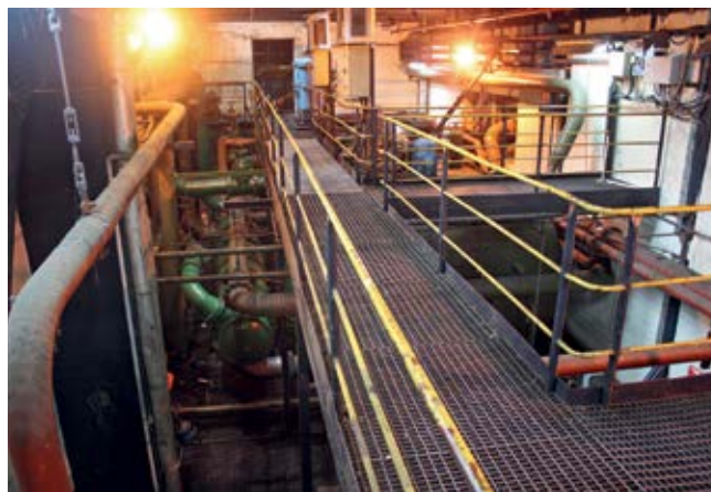
■ Хладњак уља за подмазивање турбине блока Б1
