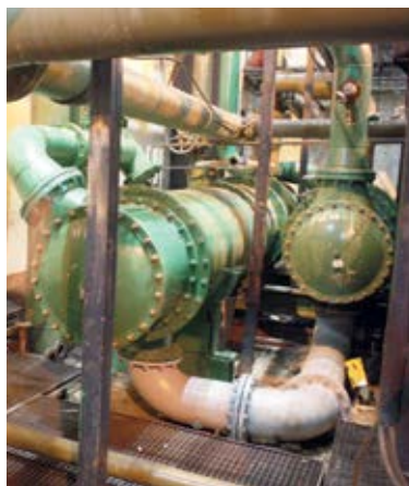
■ Хладњаци пре почетка ремонта
