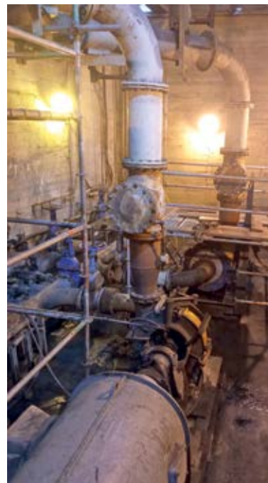
■ Багер станица део заједничког постројења
