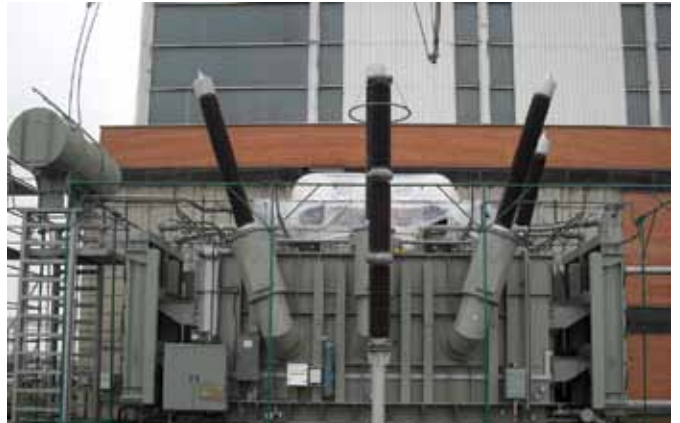
Трансформатор је тежак 450 тона са свом опремом
