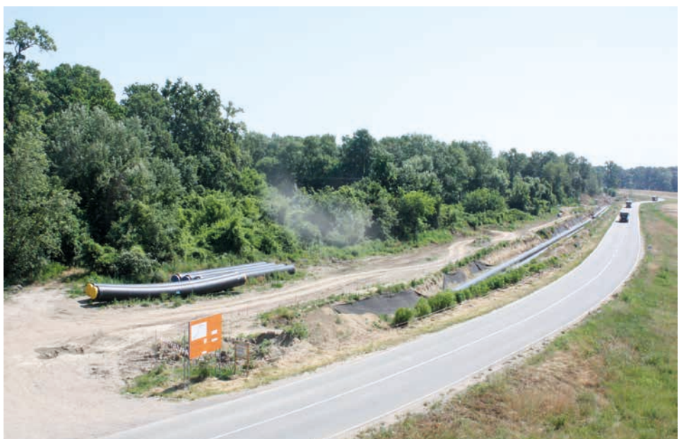
■ Део трасе топловода
