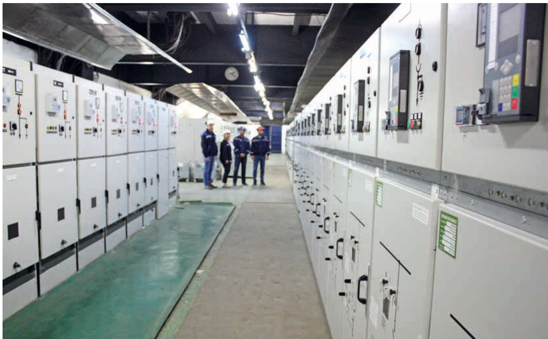
■ Разводно 6 kV постројење опште групе (десно)
