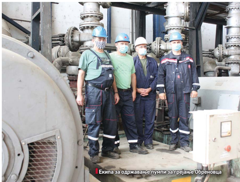
■ Контрола напојних пумпи
