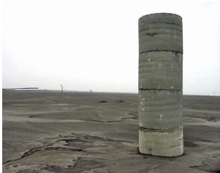
■ Једна од шахти трећег дренажног прстена
