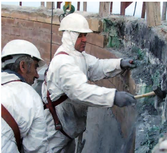
■ Унутрашње мање оштећење
