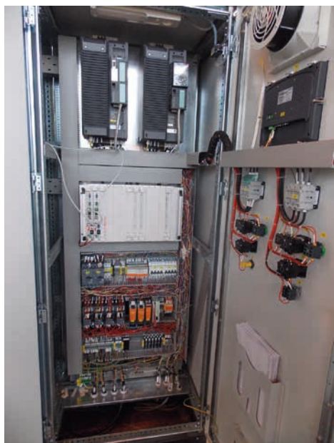
■ Аутоматизована је црпна станица ТЕНТ Б
