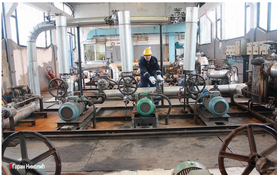
Провера нивоа мазута у резервоару
