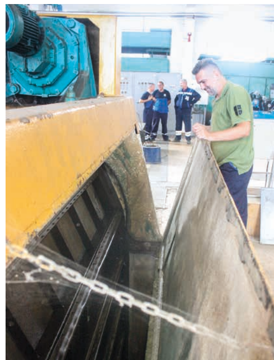
■ Провера рада Црпне станице
