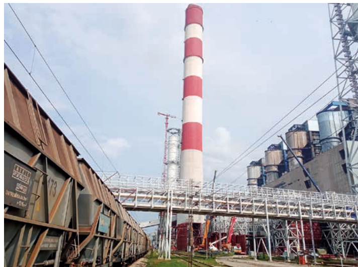
■ ОДГ постројење на локацији ТЕНТ А
