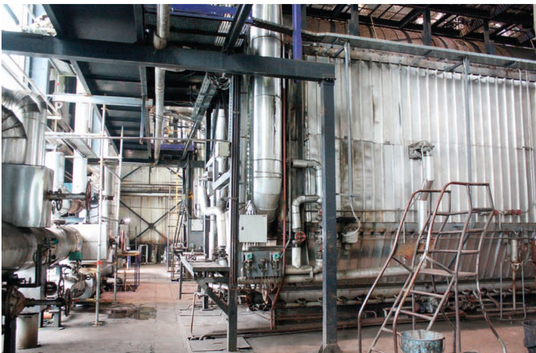
■ Унутрашњост помоћне котларнице
