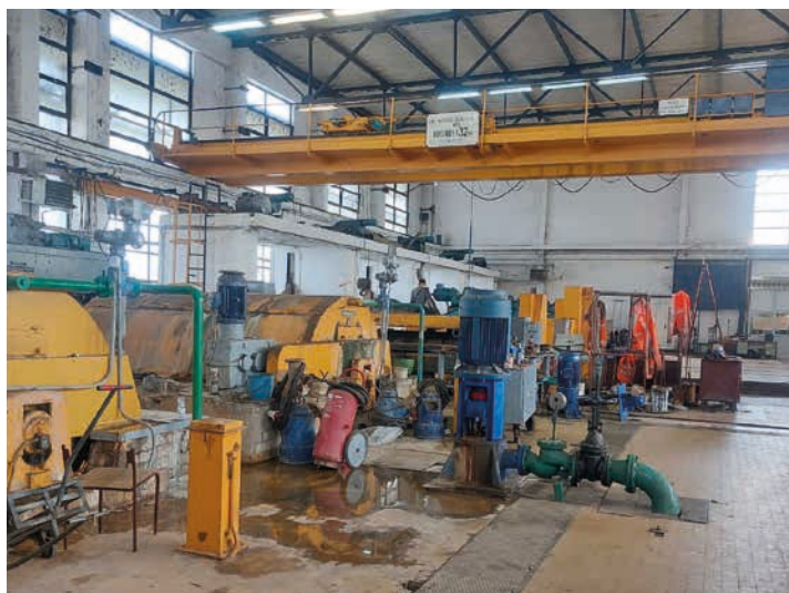
■ Унутрашњост црпне станице на коти 0 метара
